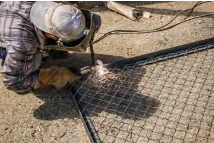
Figura 8.2. Cuando sea posible, suelde al aire libre o en un área bien ventilada.
