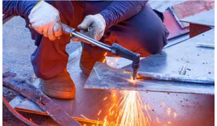
Figura 1.7. Los trabajadores están expuestos a humos y gases durante el trabajo en caliente, como el corte con soplete y la soldadura.
