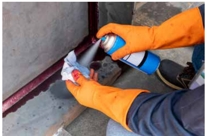
Figura 1.9. Algunos disolventes y productos químicos de mantenimiento requieren ventilación adicional y equipo de protección.
