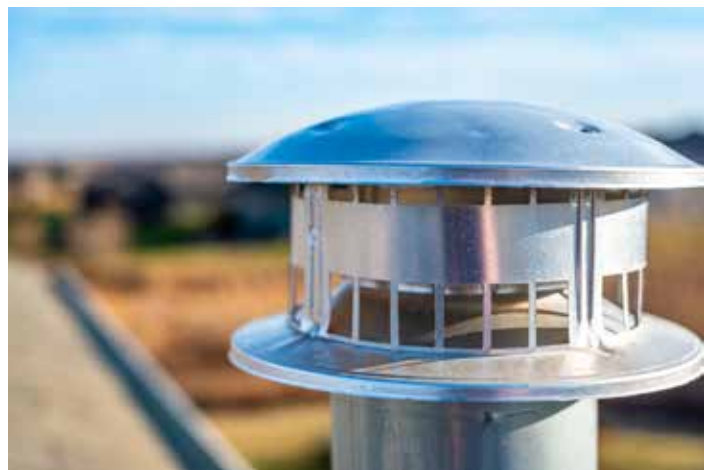
Figura 13.4. Los aparatos que funcionan con combustible deben tener ventilación hacia el aire libre.
