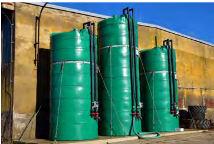
Figura 4.4. Los tanques de almacenamiento de la granja a menudo contienen poco oxígeno y gases peligrosos.
