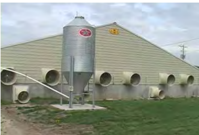
Figura 3.10. Extractores de aire para establos porcinos. Las rejillas de ventilación que reponen aire limpio están ubicadas en el lado opuesto del edificio.
