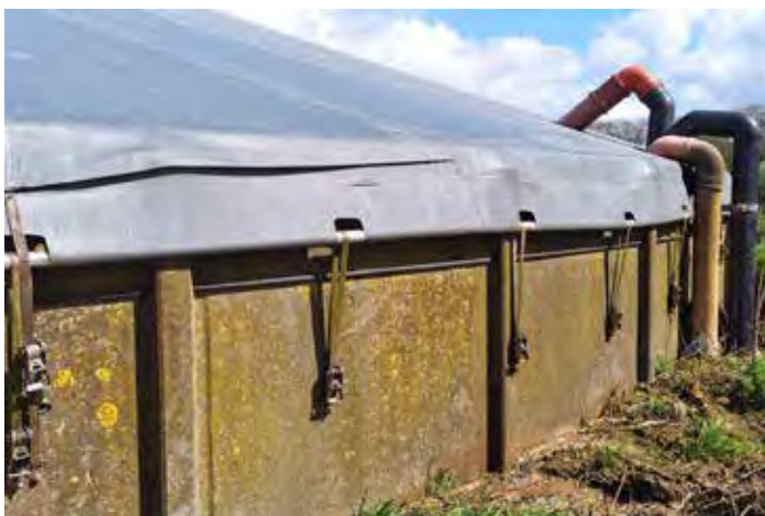
Figura 3.6. Tanque elevado de almacenamiento de estiércol cubierto.
